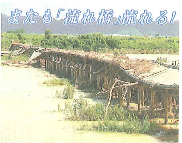
橋板が流れ損壊した「流れ橋」(上津屋)
