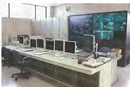
美濃山浄水場中央監視室
