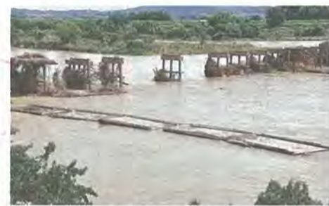
橋板が流れた流れ橋
