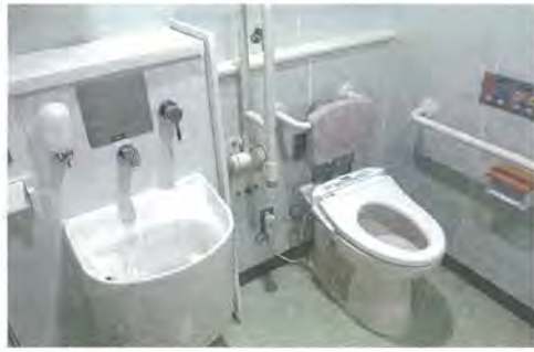
バリアフリーに対応した多目的トイレ
