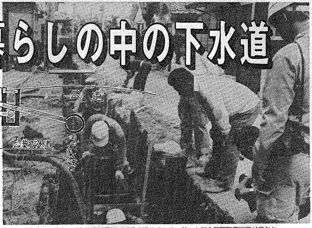
快適でうるおいのある生活環境づくりを進めるため、静々と下水道整備事業が行われています(写真は南ヶ丘保青園東で施工中の下水道管布設工事)
