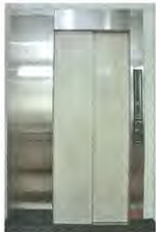
設置されたエレベーター
