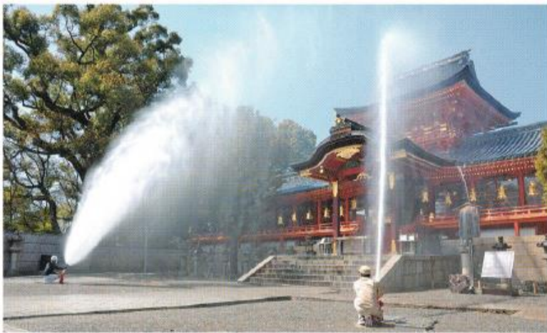
▲石清水八幡宮本社への試験放水
