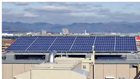
屋上に設置した太陽光パネル
