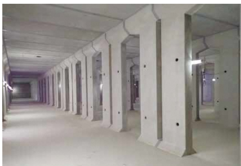
プレキャスト式雨水地下貯留施設内の写真
