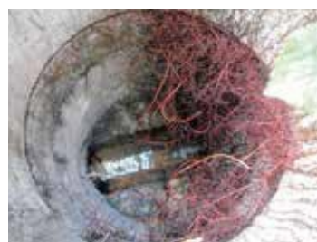
排水設備への木根侵入の様子
