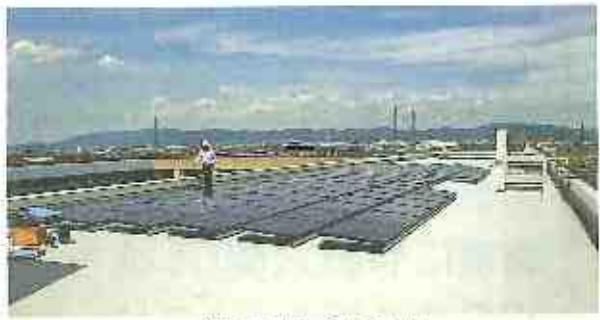
屋上に設置されたパネル(男山中)
