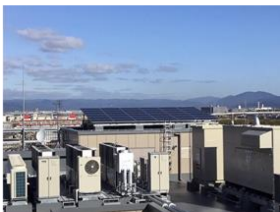
新庁舎に設置している太陽光発電パネル
