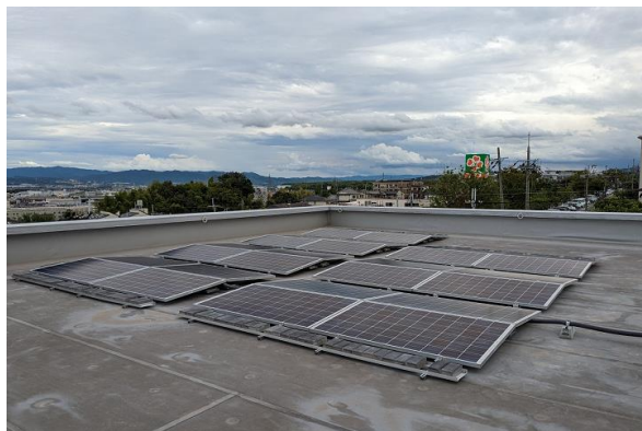
男山公民館に設置しているリユース太陽光パネル
