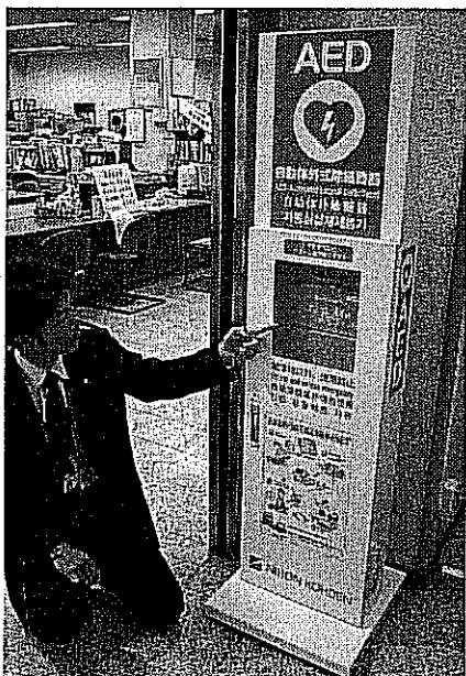
市役所1階に設置されたAED
