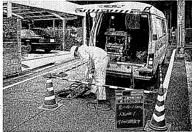
多大な経費を要する維持管理 (下水道管カメラ調査状況)
