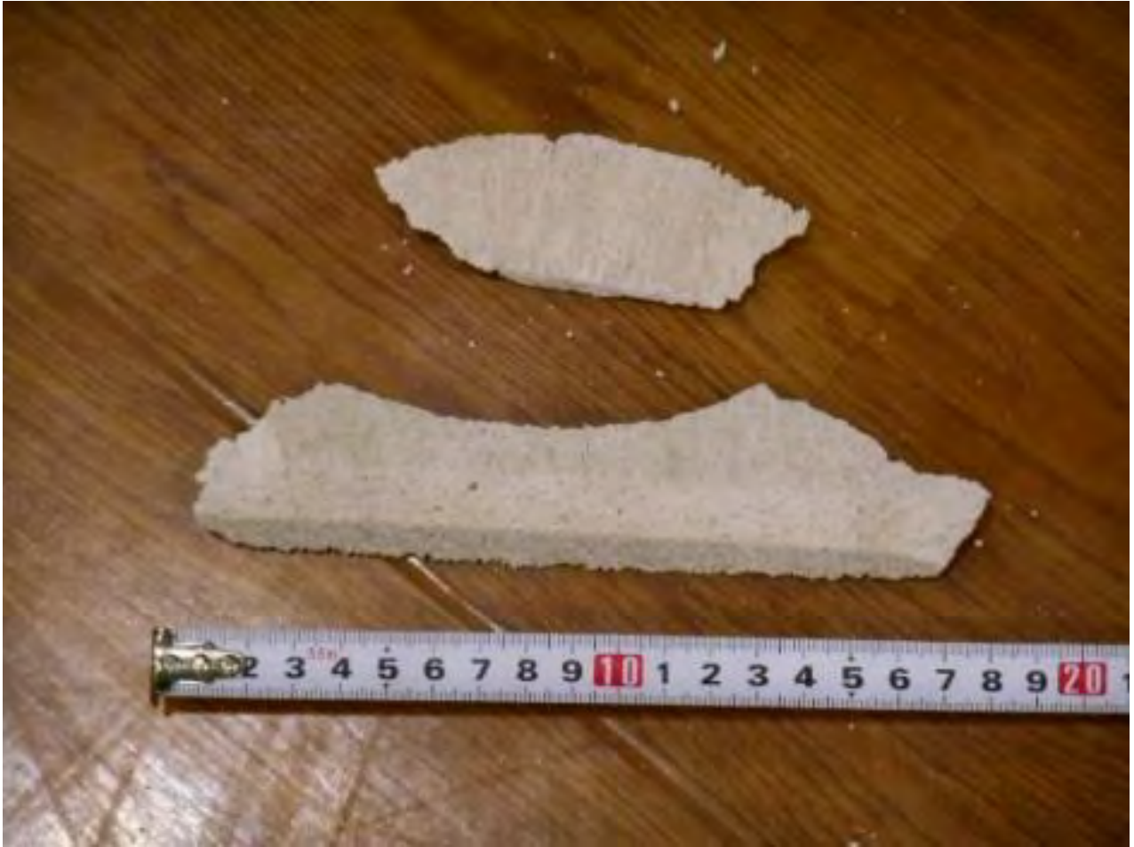
写真① 剥離したALC
