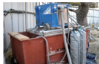
図 3-4. 雨水等の濁水処理
