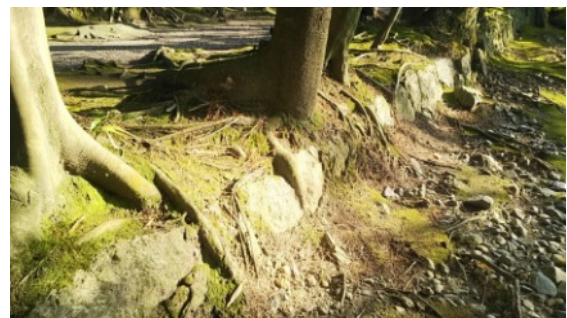
写真 5-2 樹根の延伸による石垣・石積の破損 上：築山（古墳後円部）の裾、下：名勝指定地西部
