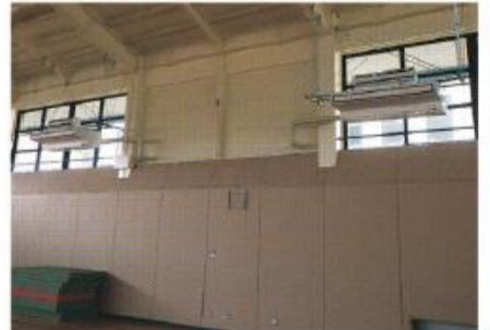
男山中学校武道場内の空調設備
