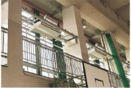
男山東中学校体育館内の空調設備
