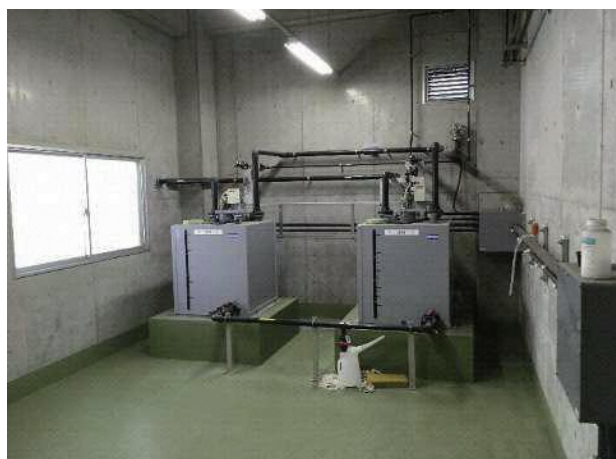
次亜塩素酸ナトリウム注入設備
