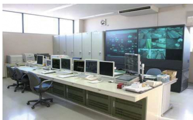
中央監視室の様子
