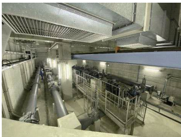
送水ポンプ室
