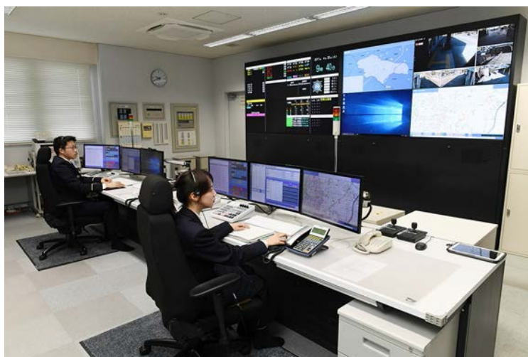
通信指令室（平成 29 年 3 月：更新）
