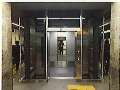
エレベーター
