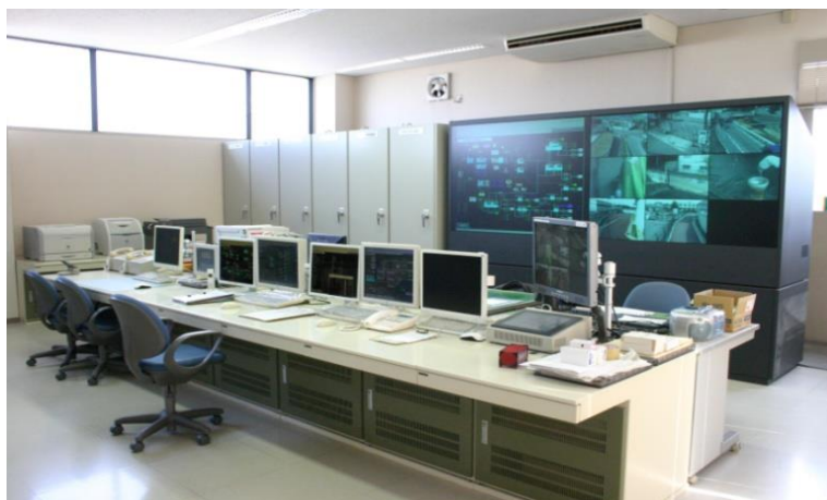
中央監視制御設備
