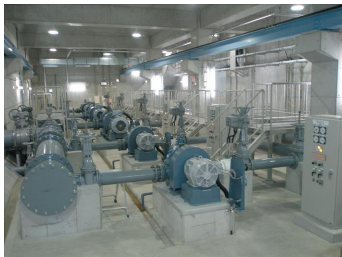
送水ポンプ施設
