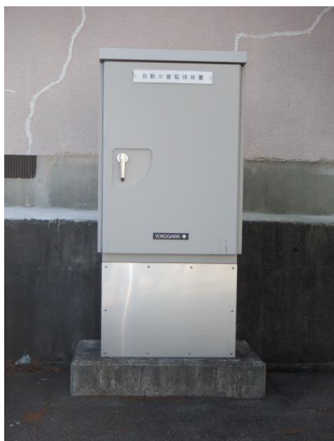
《美濃山高区配水池系統(男山吉井地内)》
