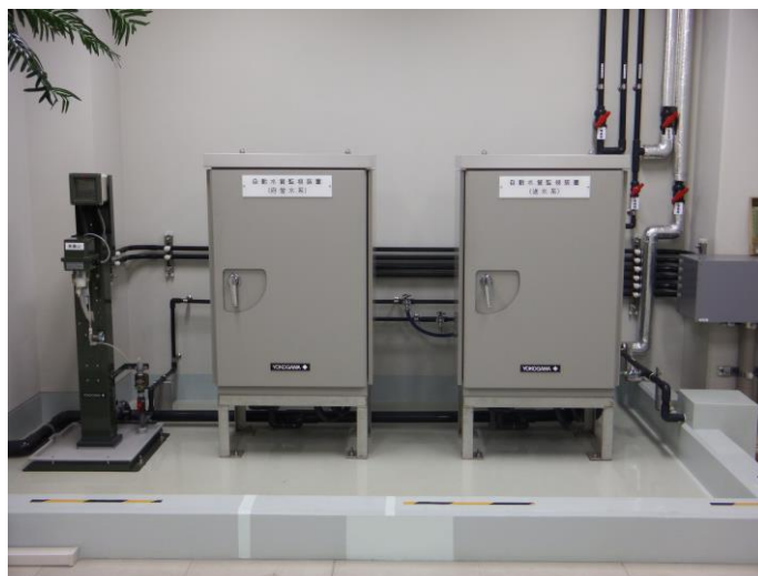
水質自動監視装置
