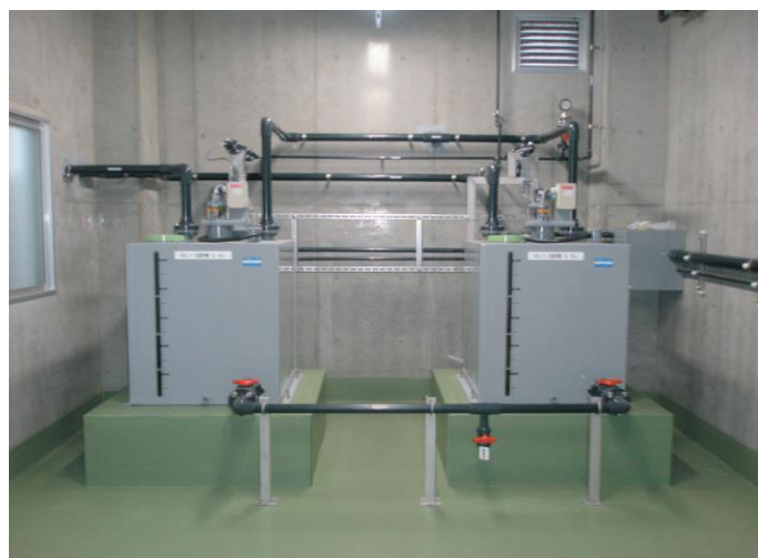
次亜塩素酸ナトリウム注入設備
