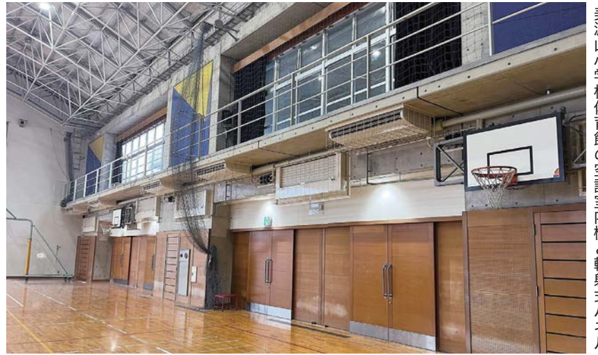
美濃山小学校体育館の空調室内機と輻射式パネル
