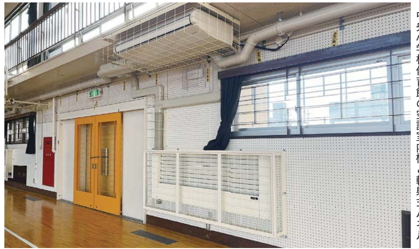
中央小学校体育館の空調室内機と輻射式パネル
