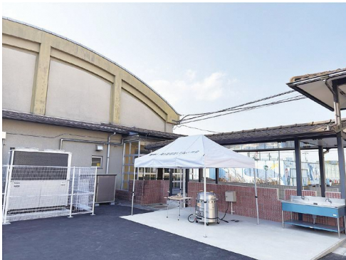
有都小学校体育館の空調室外機 (写真左)と炊き出し場
