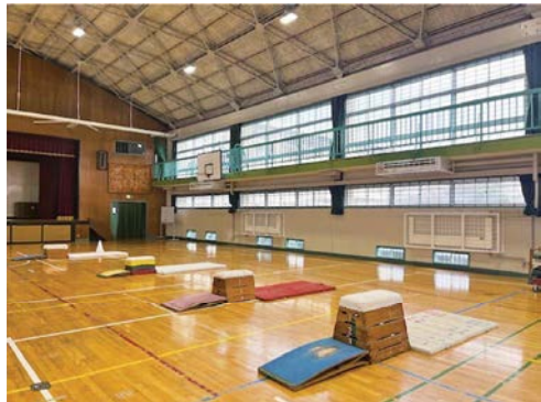
八幡小学校体育館の空調室内機と 輻射式パネル
