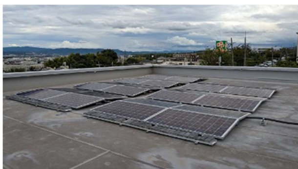
↑男山公民館に設置しているリユース太陽光パネル
