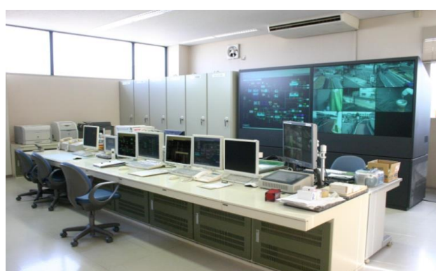
中央監視室の様子
