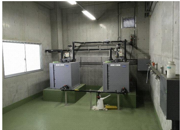
次亜塩素酸ナトリウム注入設備
