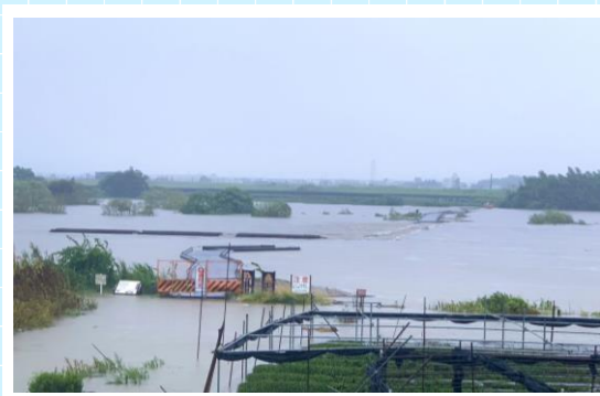
台風による増水で流れ橋が橋脚から外れる (上津屋地区・2023年)
